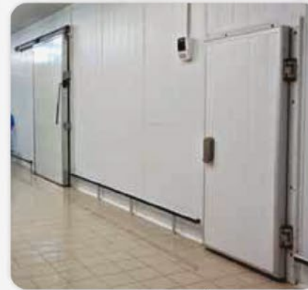
Cold Room Doors / Soğuk Oda Kapıları
